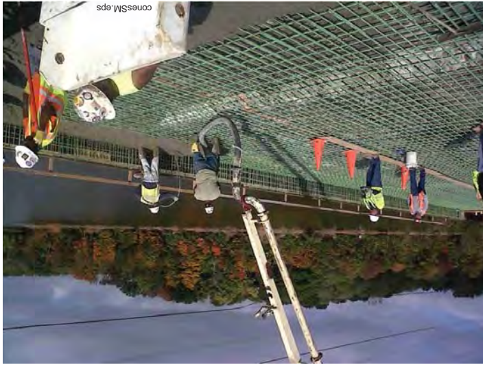
Figura 77 Uso de conos puede ayudar a identificar las zonas de peligro
